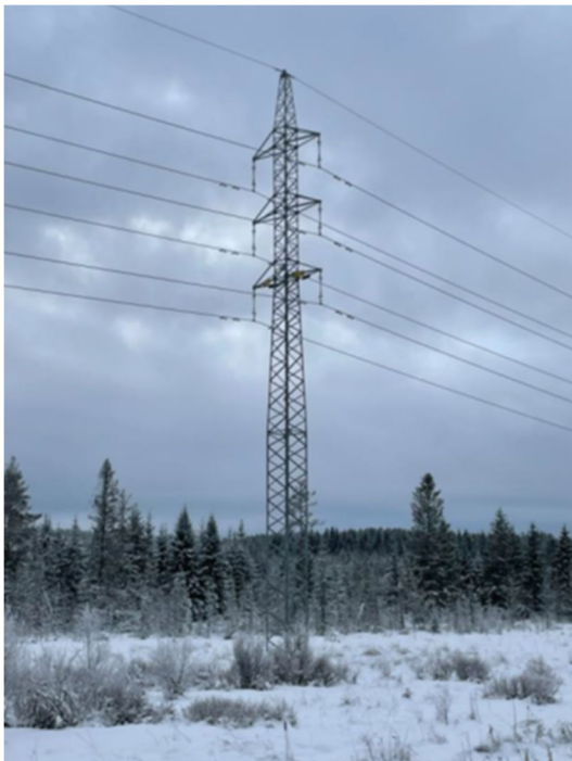
Figur 11. Exempelbild föreställande en gitterstolpe i stål av den typ som är aktuell för planerad luftledningssträckning. Även andra stolpkonstruktioner (exempelvis vinkelstolpar) kan bli aktuella.
